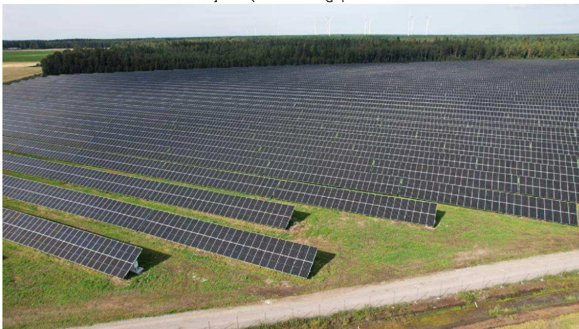
Kuva 4. Paneelirivistöt etelän suuntaan
