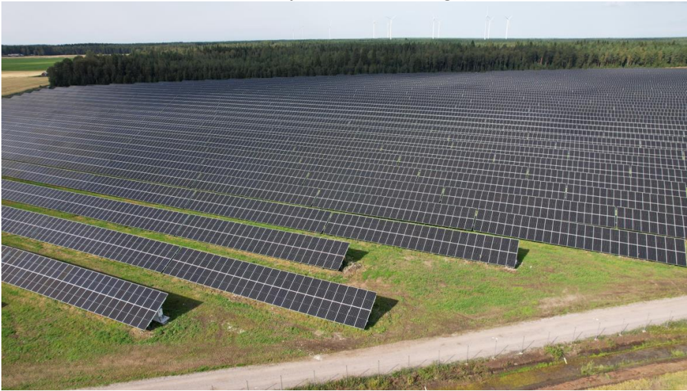
Kuva 4. Paneelirivistöt etelän suuntaan
